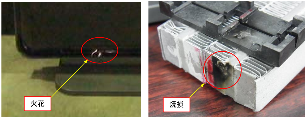
写真4. 再現テスト(左: 温風吹出口で確認された火花、右: ヒーターの焼損状態)
